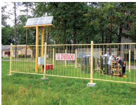
Газорегуляторные и шкафные регуляторные пункты, групповые емкостные установки оснащаются энергосберегающими системами телеметрии, позволяющими значительно снизить затраты на электрификацию и эксплуатацию объекта
