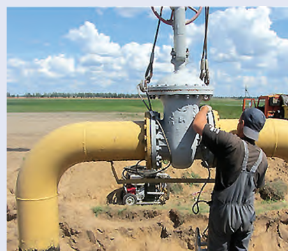
Сегодня на предприятии активно используется стоп-система, дающая возможность перекрытия газопроводов диаметром от 57 до 300 мм включительно
