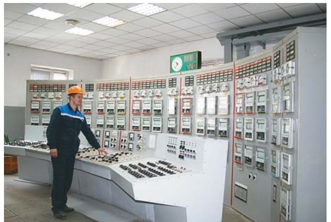
Щит управления Брестской ТЭЦ
