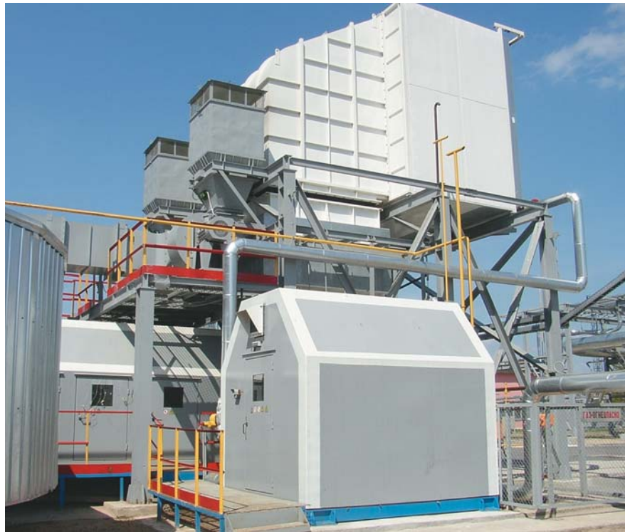
Модуль ГТУ Березовской ГРЭС
