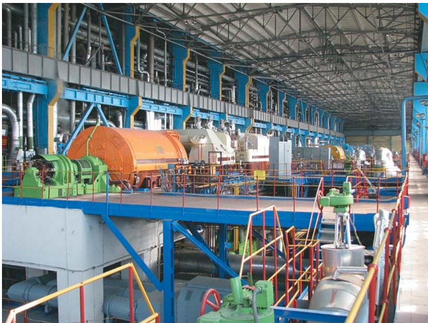
Могилевская ТЭЦ-2. Котлотурбинный цех. Турбинное отделение
