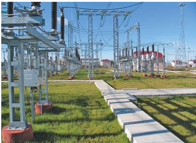
ОРУ 110 кВ ПС 330 кВ «Колядичи»
