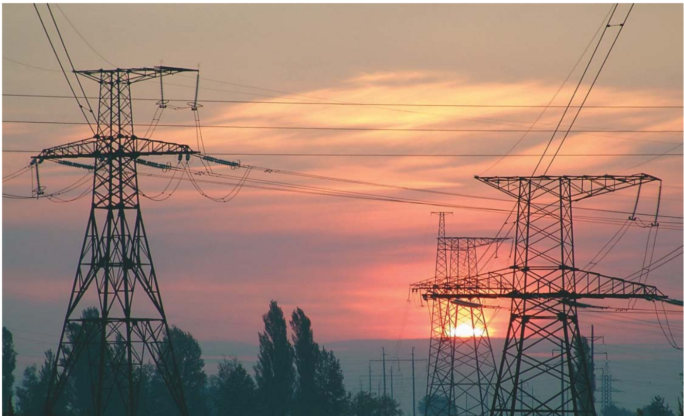
ВЛ 330 кВ в районе ПС-330 «Гомель» филиала «Гомельские электрические сети»
