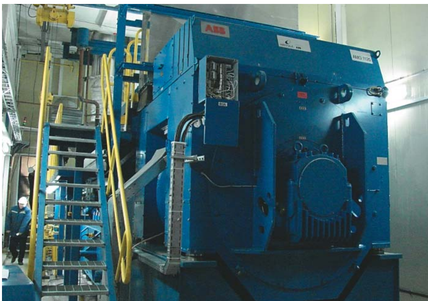
Когенерационная газопоршневая установка на Жлобинской котельной филиала «Жлобинские электрические сети»
