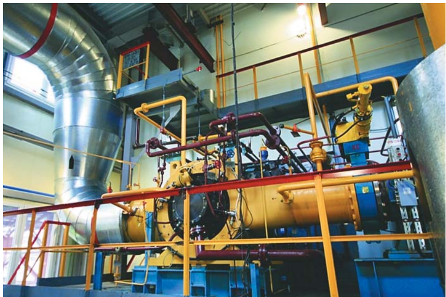
Утилизационная турбодетандерная установка на Гомельской ТЭЦ-2
