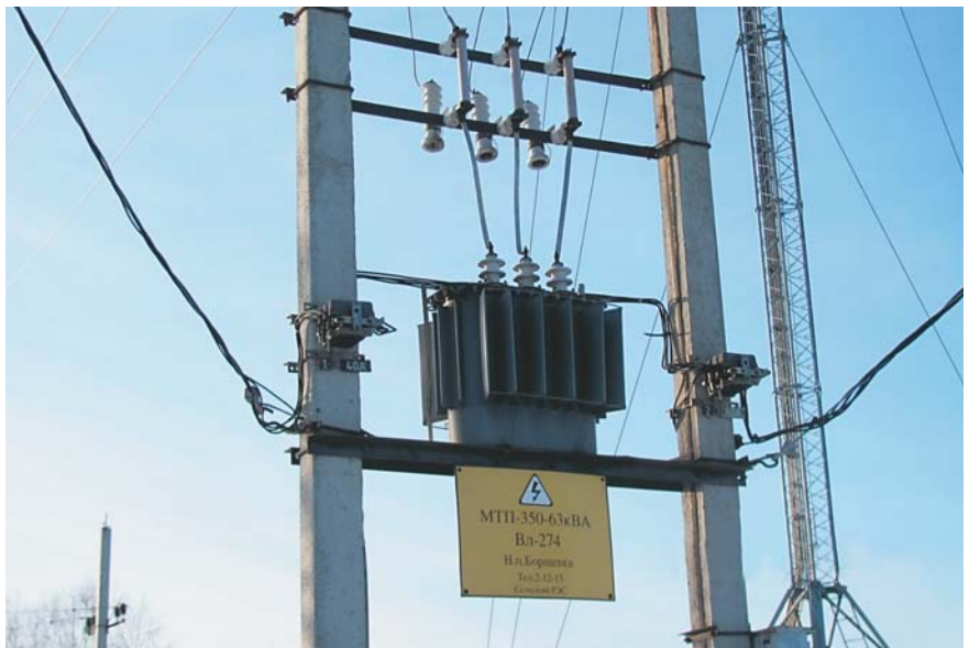
Мачтовая трансформаторная подстанция
