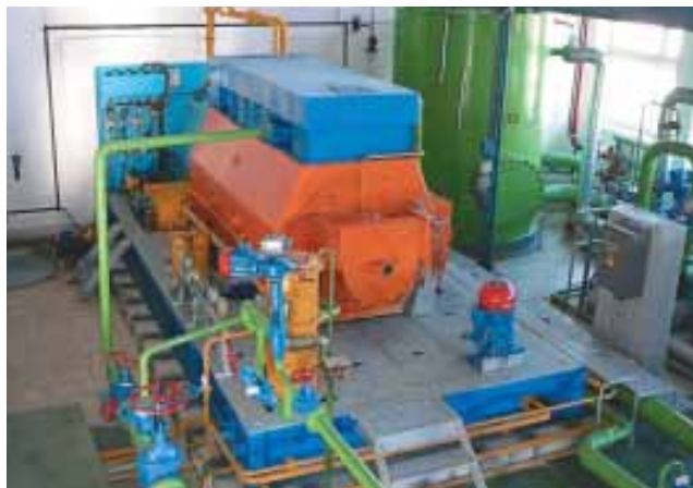
Машинный зал турбодетандерной группы оборудования
